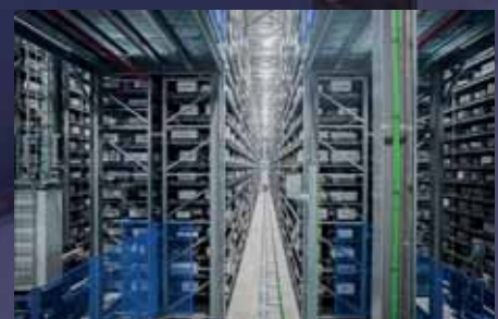
ALMACÉN AUTOMATIZADO AUTOMATIC WAREHOUSE
